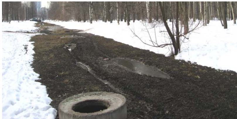
Рис. 2. Обследуемая тепловая сеть (утечки тепла по длине). Обследование проведено в зимний период
