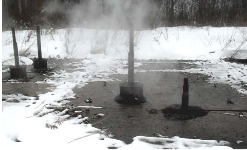
Рис. 1. Обследуемая тепловая сеть, оборудование (потери тепла)
